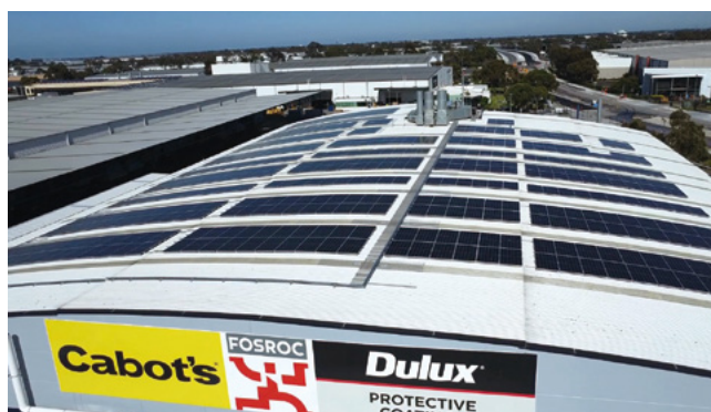
DuluxGroupダンデノンサウス工場の屋根に設置した太陽光発電設備
