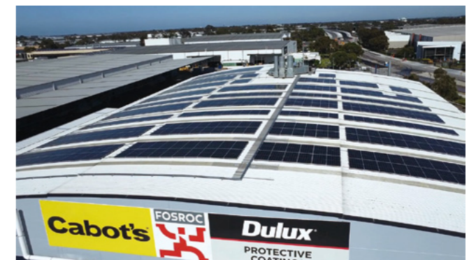
DuluxGroupダンデンンサウス工場の屋根に設置した太陽光発電設備
