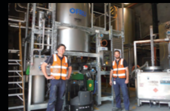
溶剤回収プラント
